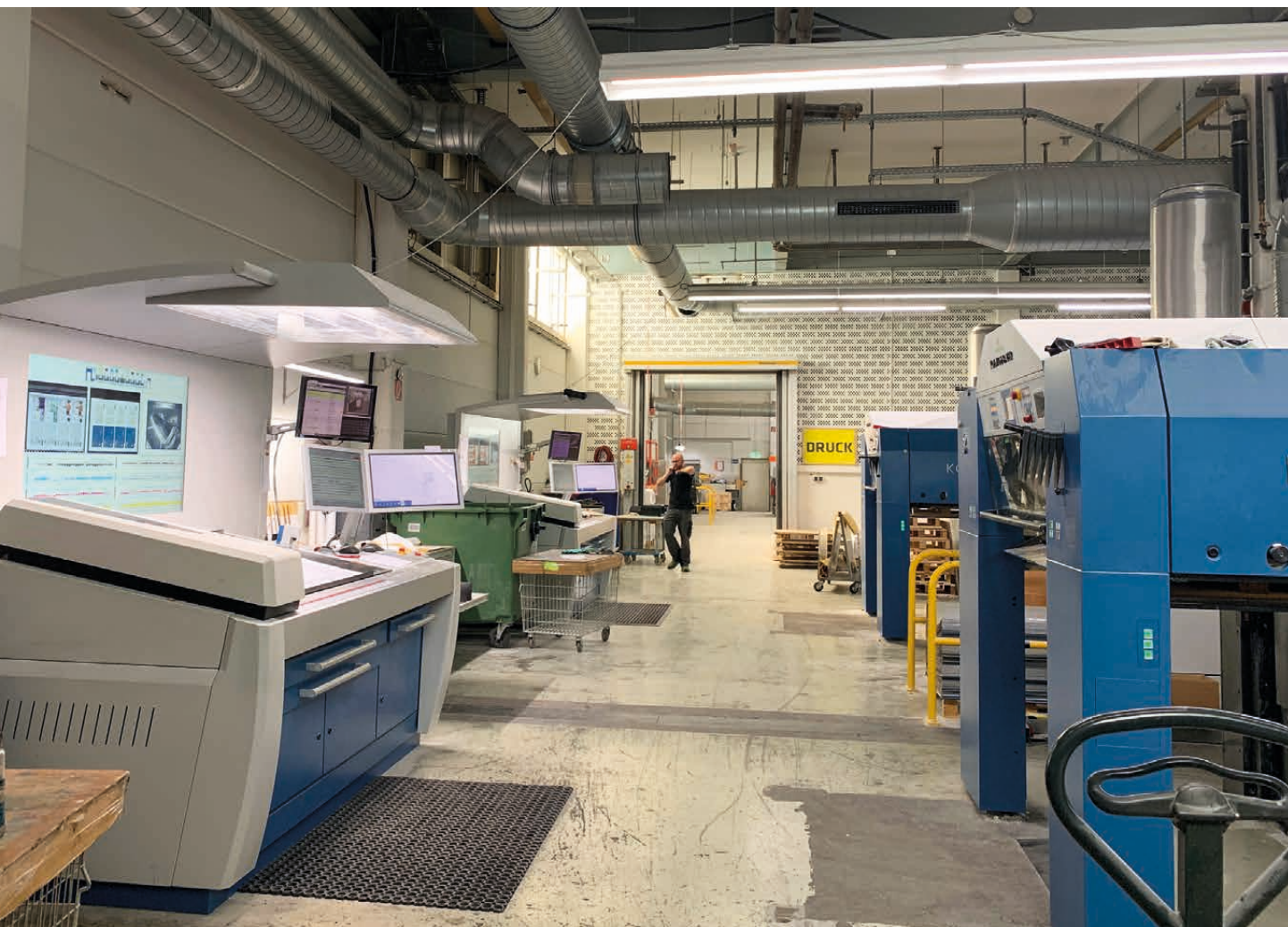
Typische Beleuchtungssituation in einem Drucksaal. Die Leitstände sind mit D50 Normlicht ausgestattet, hinzu kommt natürliches und künstliches Umgebungslicht.
